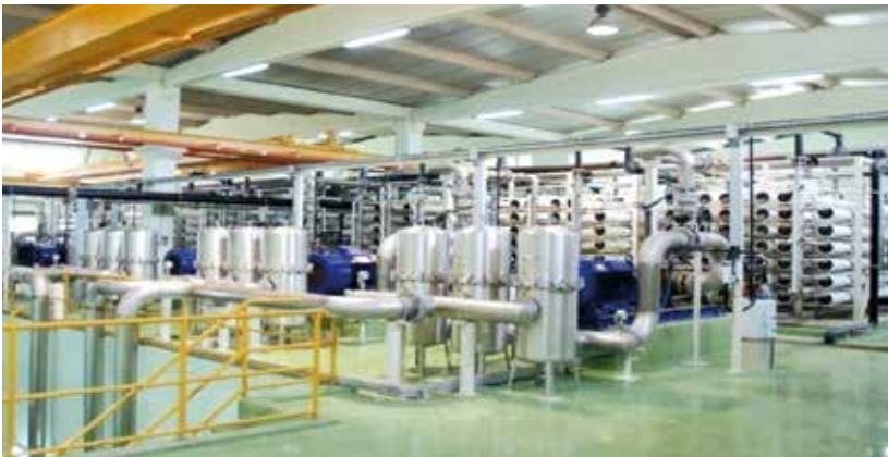
Bursa OSB (BTSO) Atıksu Geri Kazanım Tesisi Kapasite: 50.000 m 3 /gün
